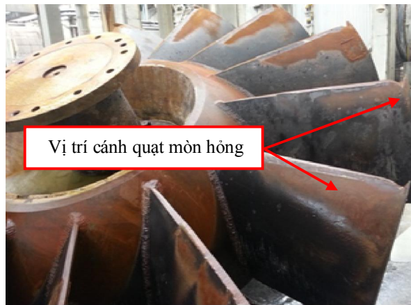
Hình 3. Cánh quạt khói bụi công nghiệp bị mòn hỏng
